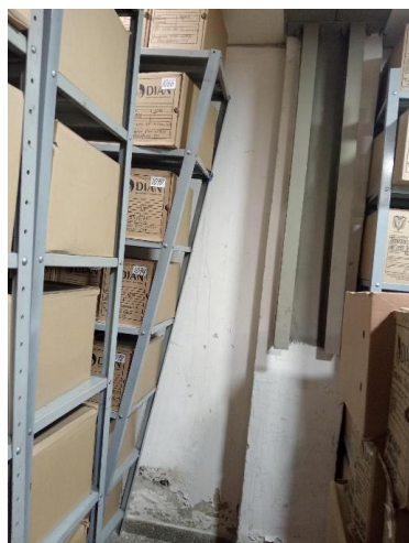
Imagen 5. Paredes con presencia de humedad
