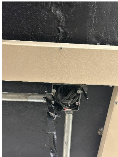
Imagen 3. Instalación eléctrica sin protección
