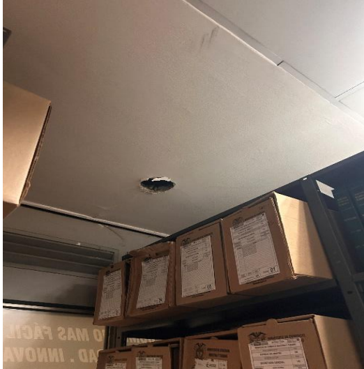
Imagen 1. Techos sin protección
