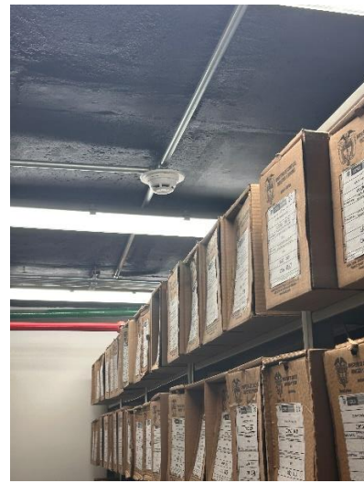
Imagen 4. Luminarias a menos de 40 cm
