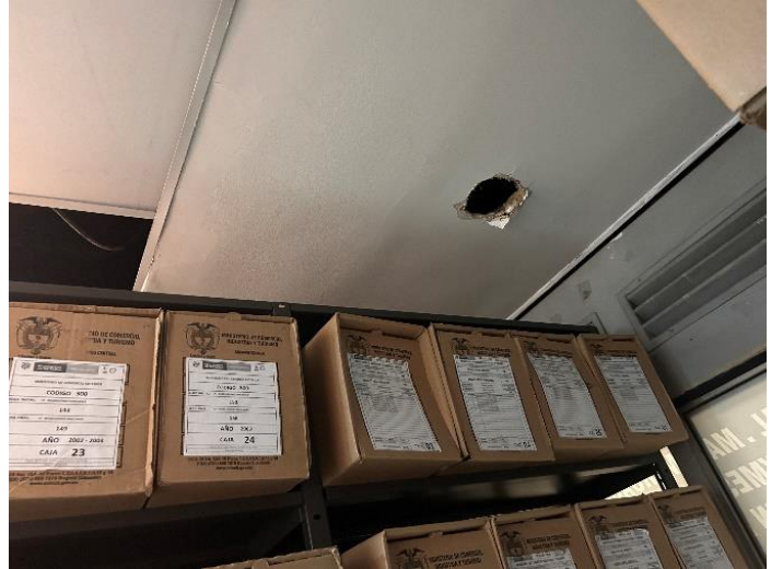
Imagen 2. Techos sin protección
