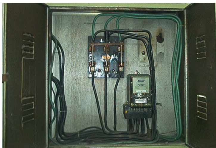
Foto 1. Tablero medidor piso 2 actual
