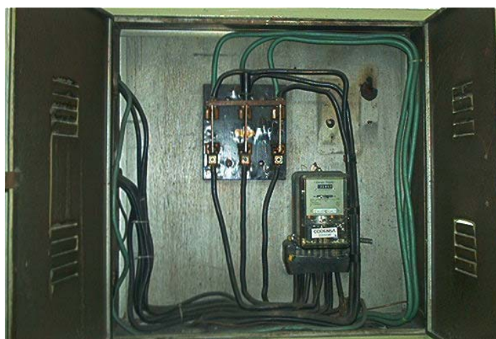
Foto 2. Tablero medidor actual
