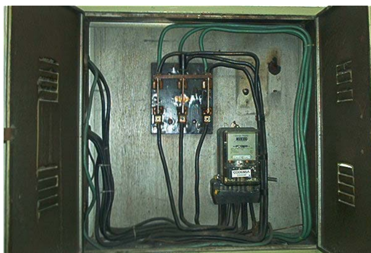
Foto 2. Tablero medidor actual
