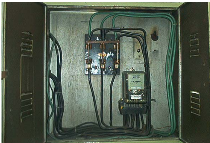
Foto 1. Tablero medidor piso 2 actual
