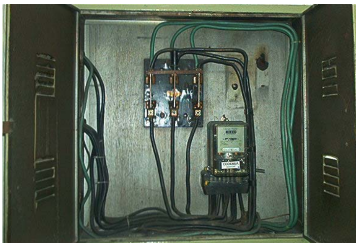
Foto 1. Tablero medidor piso 2 actual
